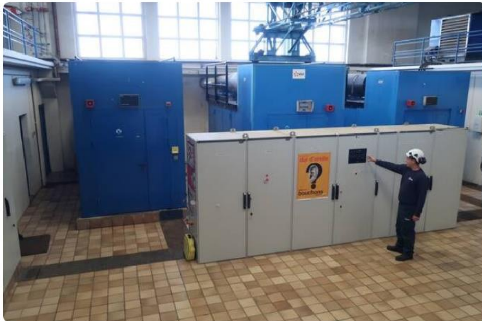
Trois groupes électrogènes fonctionnant au fioul sont installés dans le phare de Sein pour assurer l'alimentation en électricité de l'île. | OUEST-FRANCE
